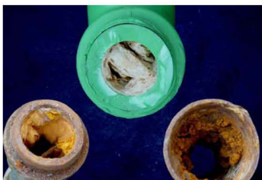
Καταστροφή σωληνώσεων λόγω των επικαθίσεων δυσδιάλυτων αλάτων ασβεστίου-μαγνησίου.
